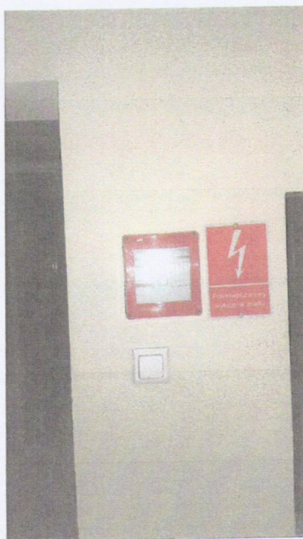
Miejsce lokalizacji pożarowego wyłącznika prądu na ścianie portierni w holu głównym
